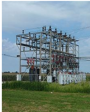
Subestação de energia
